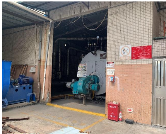
6t/h“低氮燃烧”燃气锅炉
